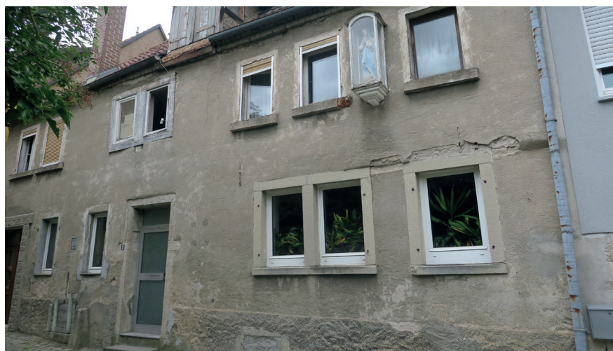
Gebäude mit hohen gestalterischen Mängeln
